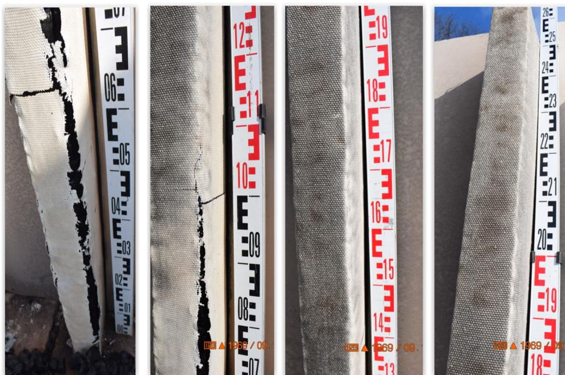
Rysunek 76. Uszkodzenia powłoki z wermikulitem
