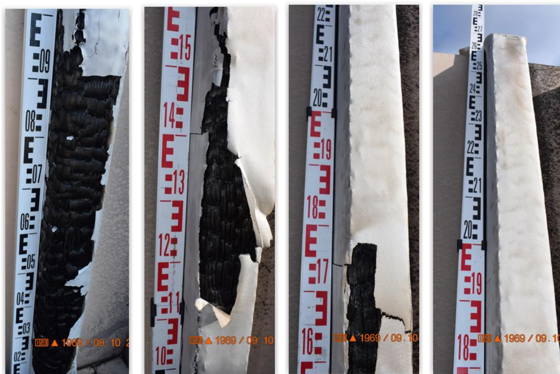
Rysunek 75. Uszkodzenia powłoki z natryskiem aluminium
