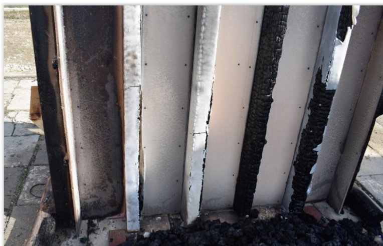
Rysunek 74. Stan ściany po zakończeniu badania oraz przechłodzeniu ściany do temp. 30°C
