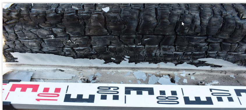
Rysunek 80. Pozostałości powłoki z modyfikacją aluminium po zdemontowaniu płyty GKF między elementami
