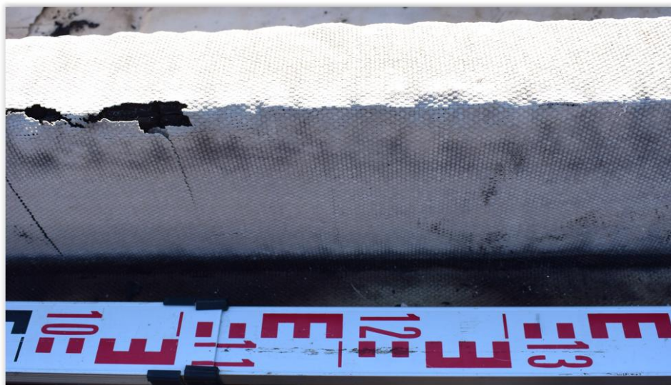
Rysunek 83. Pozostałości powłoki z modyfikacją wermikulitem po zdemontowaniu płyty GKF między elementami
