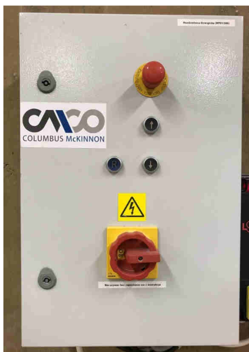
Rysunek 16 Skrzynka sterująca dźwignika zamontowana w obiekcie
