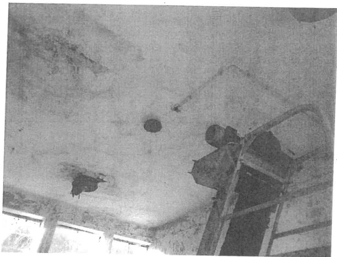
Fot. 10,11. Wnętrze budynku krat. Skorodowane wyrzutnie wentylacji grawitacyjnej. Widoczne wykwity spowodowane nieszczelnościami dachu
