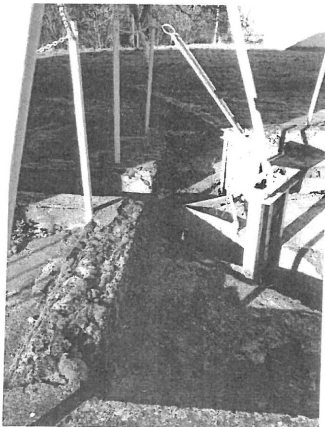
Fot.15. Kierownica betonowa z zamontowanym zabezpieczeniem stalowym wraz z zastawkami drewnianymi. Widoczna erozja betonu.
