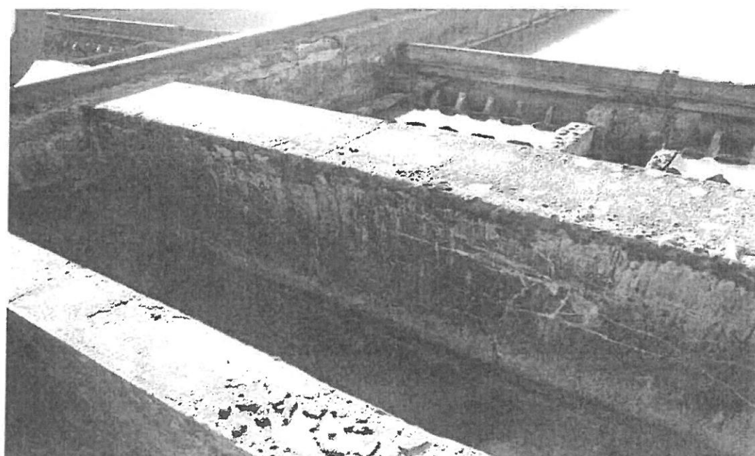
Fot. 32,33,34,35. Wyflwy pilaste z osadników z widocznymi ubytkami ścianek betonowych i erozją wierzchniej części ścian
