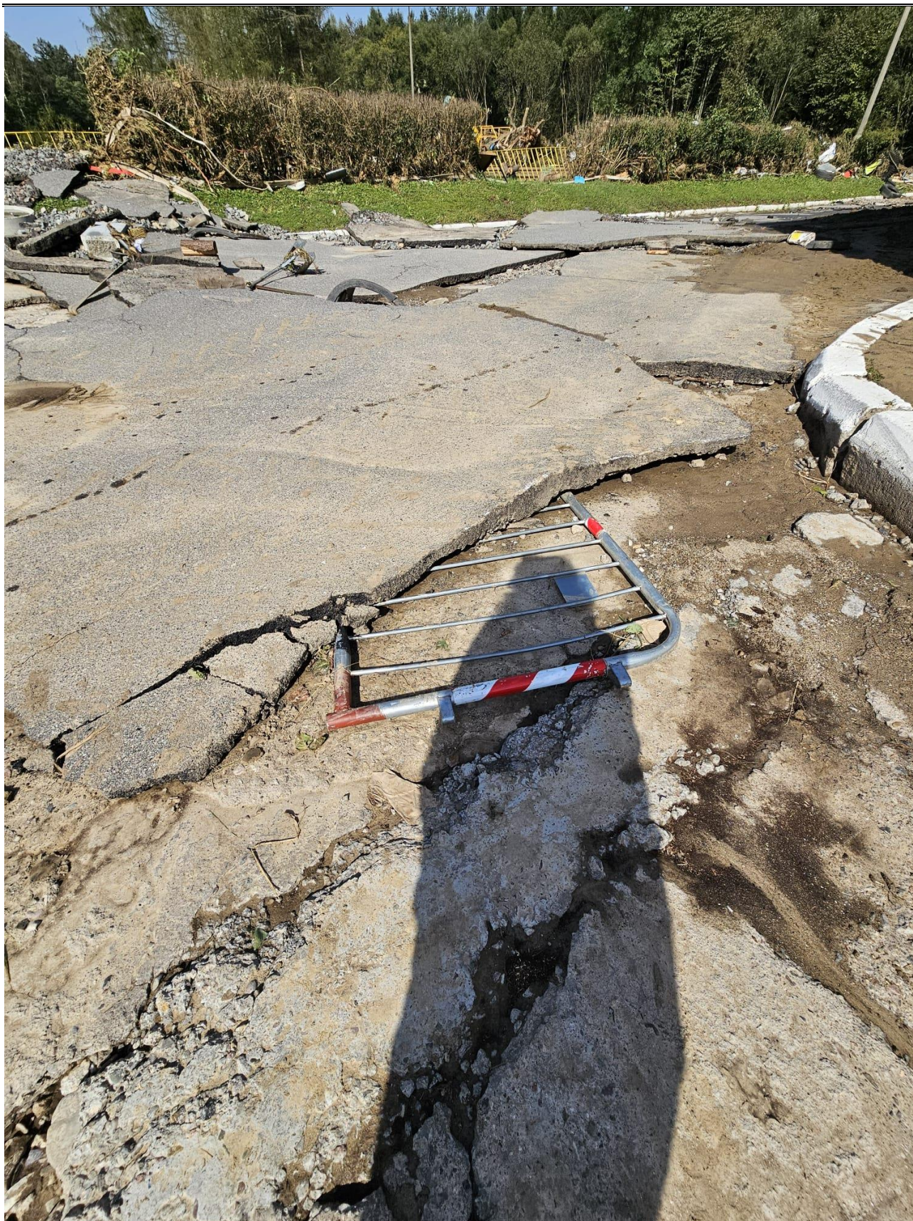
Fot. nr 3 – Oczyszczalnia ścieków w Łądku Zdroju 2024.09.17 drogi wewnętrzne (dwa dni po fali powodziowej)
