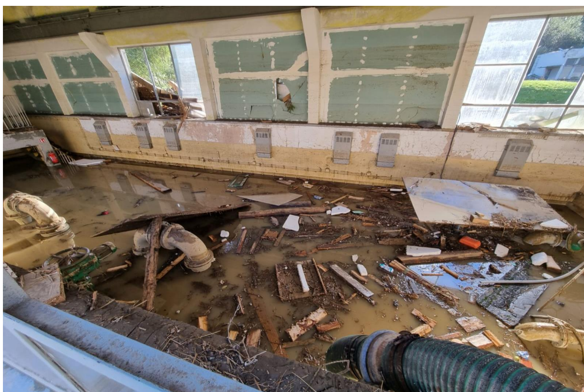
Fot. nr 5 – Oczyszczalnia ścieków w Łądku Zdroju – Pompownia ścieków i osadów 2024.09.23 (tydzień po fali powodziowej)
