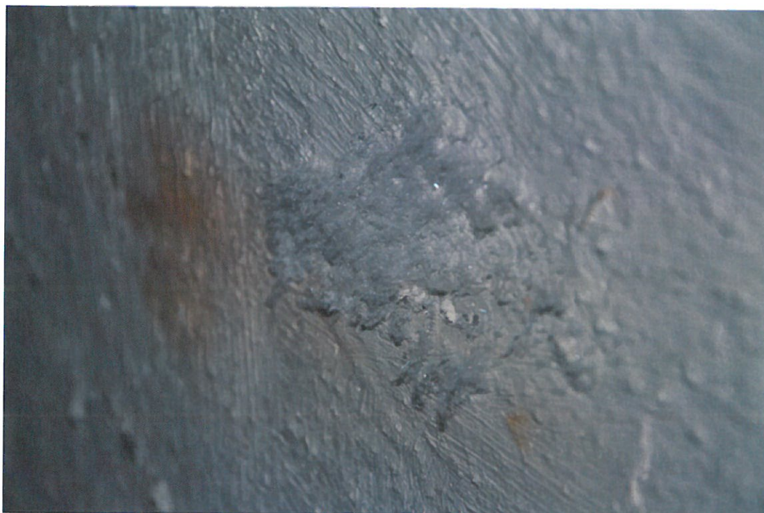
Fot.7. Wysolenia na zewnętrznej ścianie piwnicy
