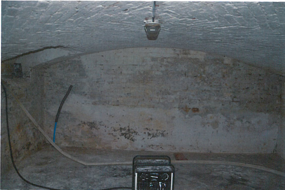
Fot.3. Widok piwnic. Widoczne zawilgocenie ścian (wysolenia, odparzenia) i lokalny wzrost grzybów pleśniowych. Jednocześnie widoczna wtórna wyprawa (tynk cementowy) w miejscach wcześniejszych wysoleń
