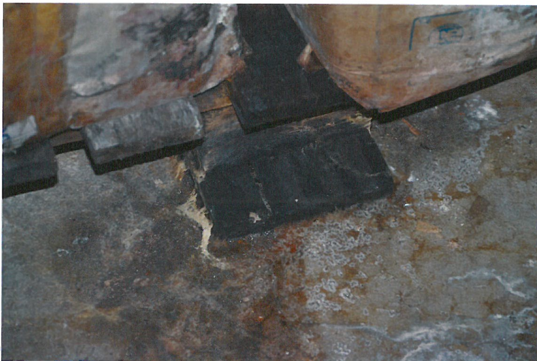
Fot.23. Zagrzybienie (rozkład brunatny) drewnianych przedmiotów znajdujących się w piwnicy. Widoczna grzybnia i sznury grzybniowe grzyba gnilicy mózgowatej
