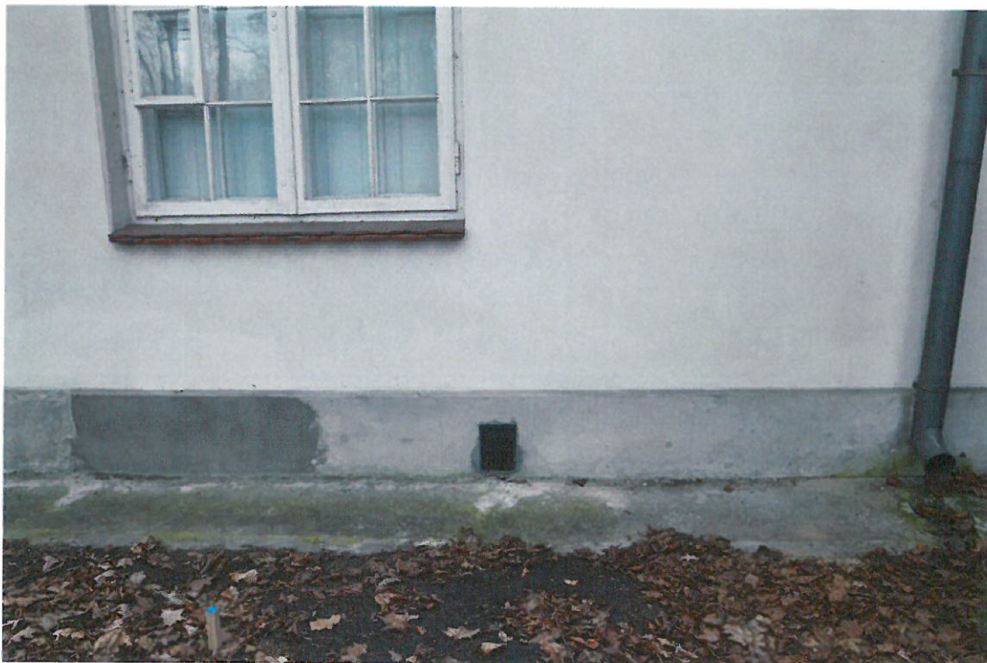
Fot.15. Otwór wentylacyjny piwnicy i brak wentylacji stropu przyziemia
