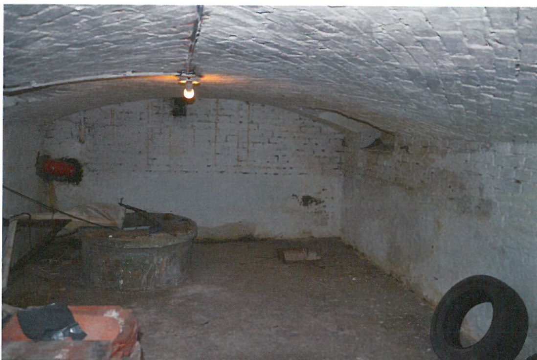
Fot.2. Widok piwnic. Widoczne zawilgocenie ścian (wysolenia, odparzenia) i lokalny wzrost grzybów pleśniowych. Jednocześnie widoczna wtórna wyprawa (tynk cementowy) w miejscach wcześniejszych wysoleń
