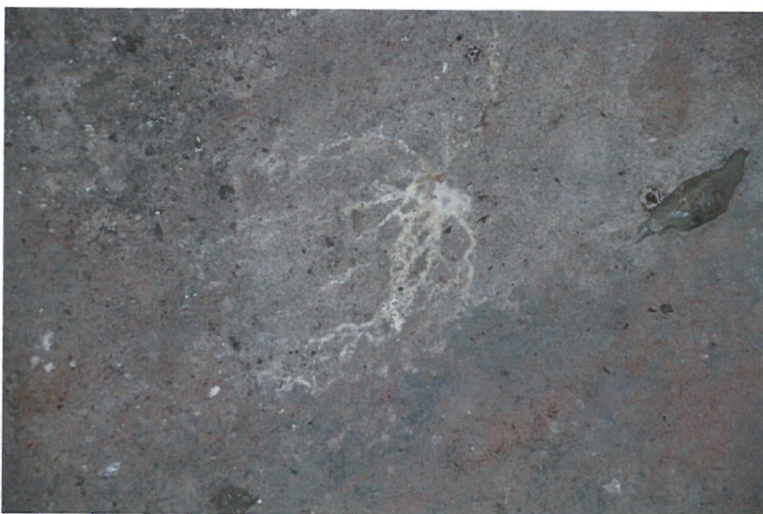
Fot.26. Zagrzybienie (rozkład brunatny) drewnianych przedmiotów znajdujących się w piwnicy. Widoczna grzybnia i sznury grzybniowe grzyba gnilicy mózgowatej porastające tynk
