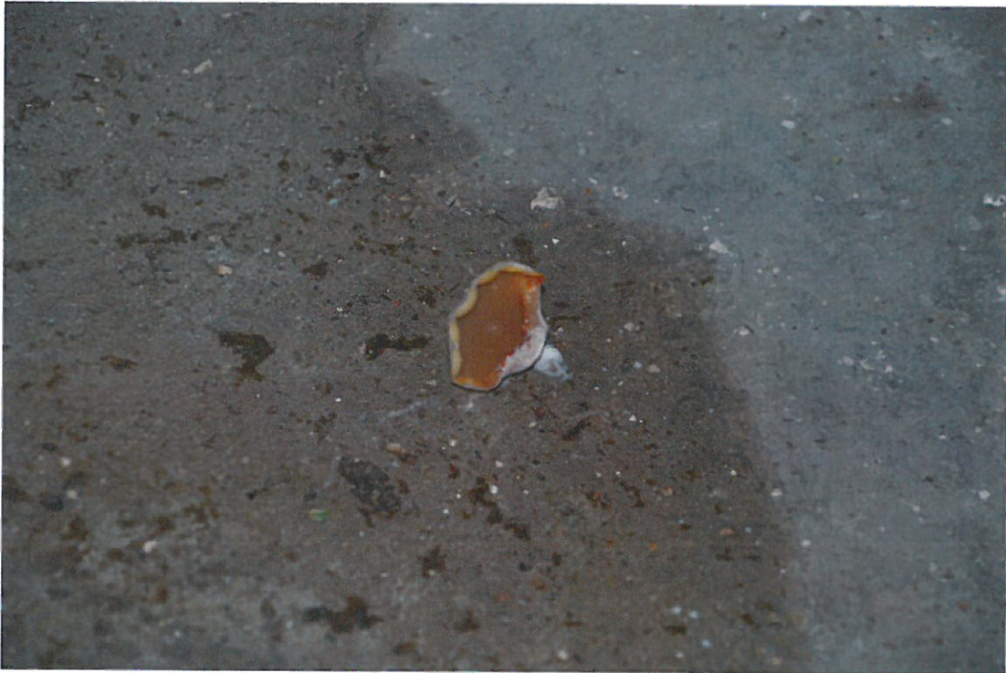
Fot.27. Owocnik grzyba z rodzaju Peziza sp. wyrastający w betonowej posadzki
