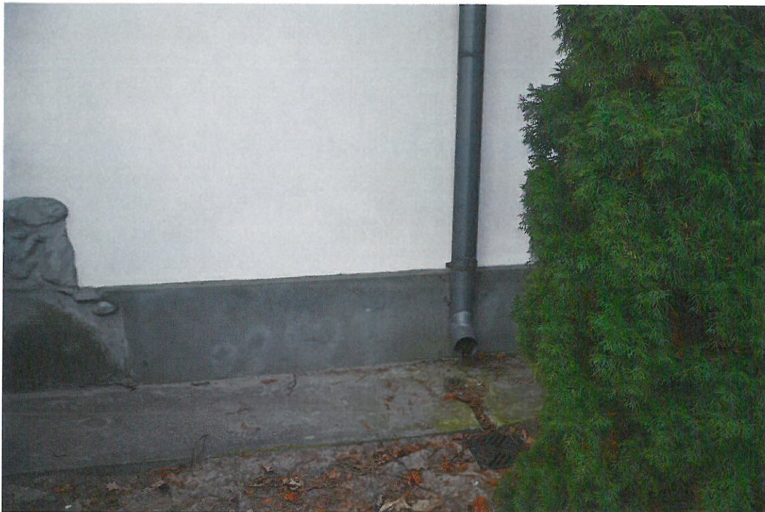
Fot.11. Wysolenia i odparzenia tynku wskazujące na podciąganie kapilarne wody. Jednocześnie widoczna studzienka chłonna dla wody opadowej – brak kanalizacji burzowej
