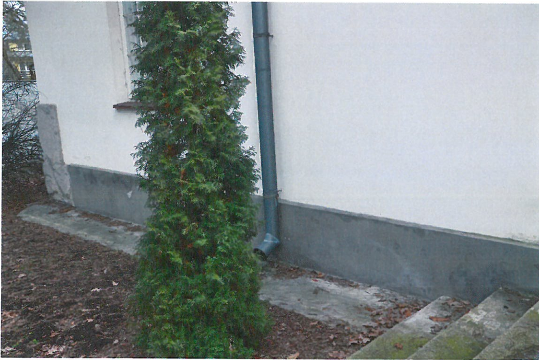
Fot.13. Wysolenia i odparzenia tynku wskazujące na podciąganie kapilarne wody. Jednocześnie widoczny brak otworów wentylacyjnych stropu przyziemia
