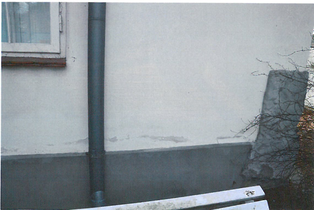
Fot.10. Wysolenia i odparzenia tynku wskazujące na podciąganie kapilarne wody. Jednocześnie widoczny brak otworów wentylacyjnych stropu przyziemia oraz poziome ukształtowanie korony cokołu bez obróbki blacharskiej
