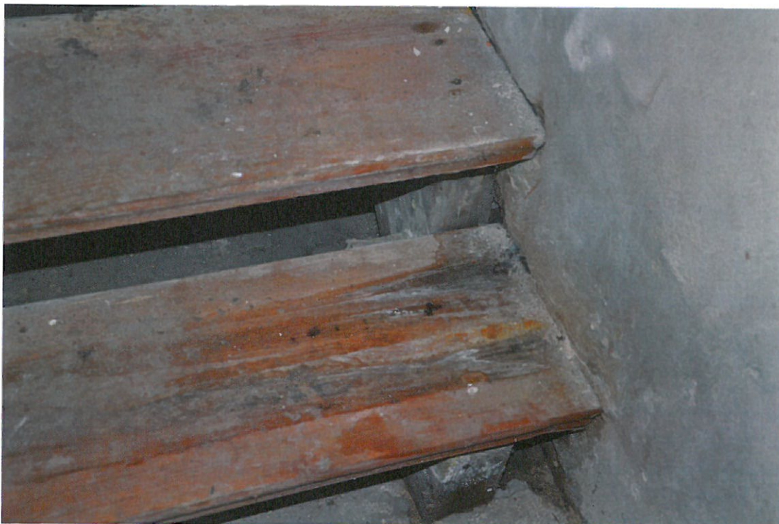
Fot.21. Początkowe stadia zagrzybienia drewnianych schodów
