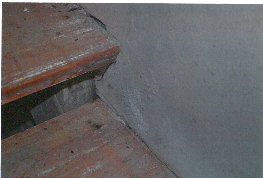
Fot.8. Rejon schodów do piwnicy. Wysolenia na wewnętrznej ścianie piwnicy wskazujące na działanie wód gruntowych
