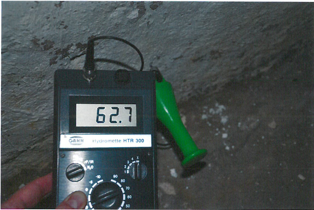
Fot.17. Pomiar wilgotności muru piwnic. Odczyt 63 jednostek pomiarowych odpowiada wilgotności muru około 8%
