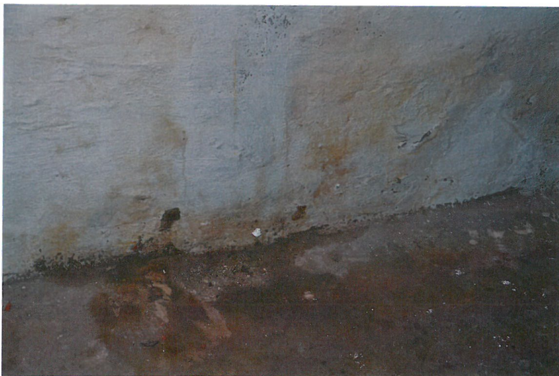
Fot.5. Rozległe wysolenia i odparzenia wtórnego tynku. Lokalny wzrost kolonii grzybów pleśni
