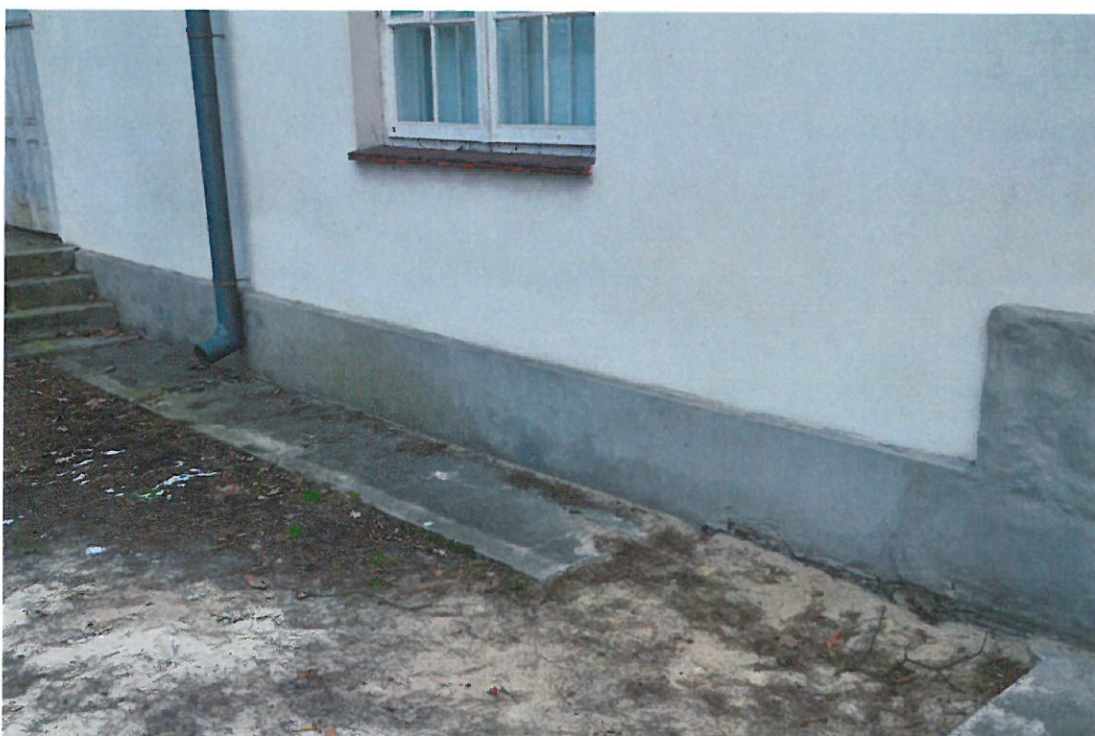
Fot.12. Wysolenia i odparzenia tynku wskazujące na podciąganie kapilarne wody. Jednocześnie widoczny brak otworów wentylacyjnych stropu przyziemia oraz poziome ukształtowanie korony cokołu bez obróbki blacharskiej
