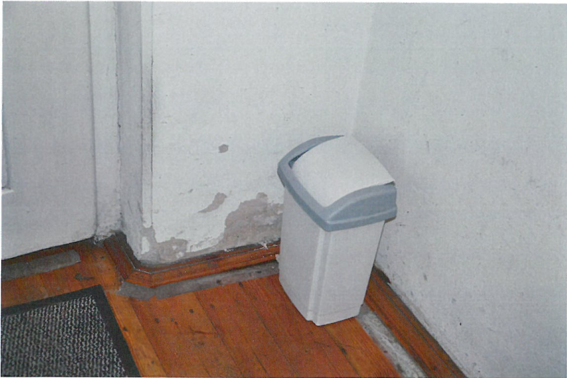
Fot.9. Wysolenia i odparzenia tynku w rejonie drzwi kuchennych wskazujące na podciąganie kapilarne wody
