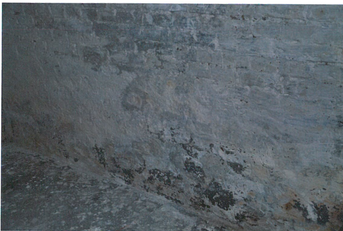
Fot.6. Widok piwnic. Widoczne zawilgocenie ścian (wysolenia, odparzenia) i lokalny wzrost grzybów pleśniowych. Jednocześnie widoczna wtórna wyprawa (tynk cementowy) w miejscach wcześniejszych wysoleń
