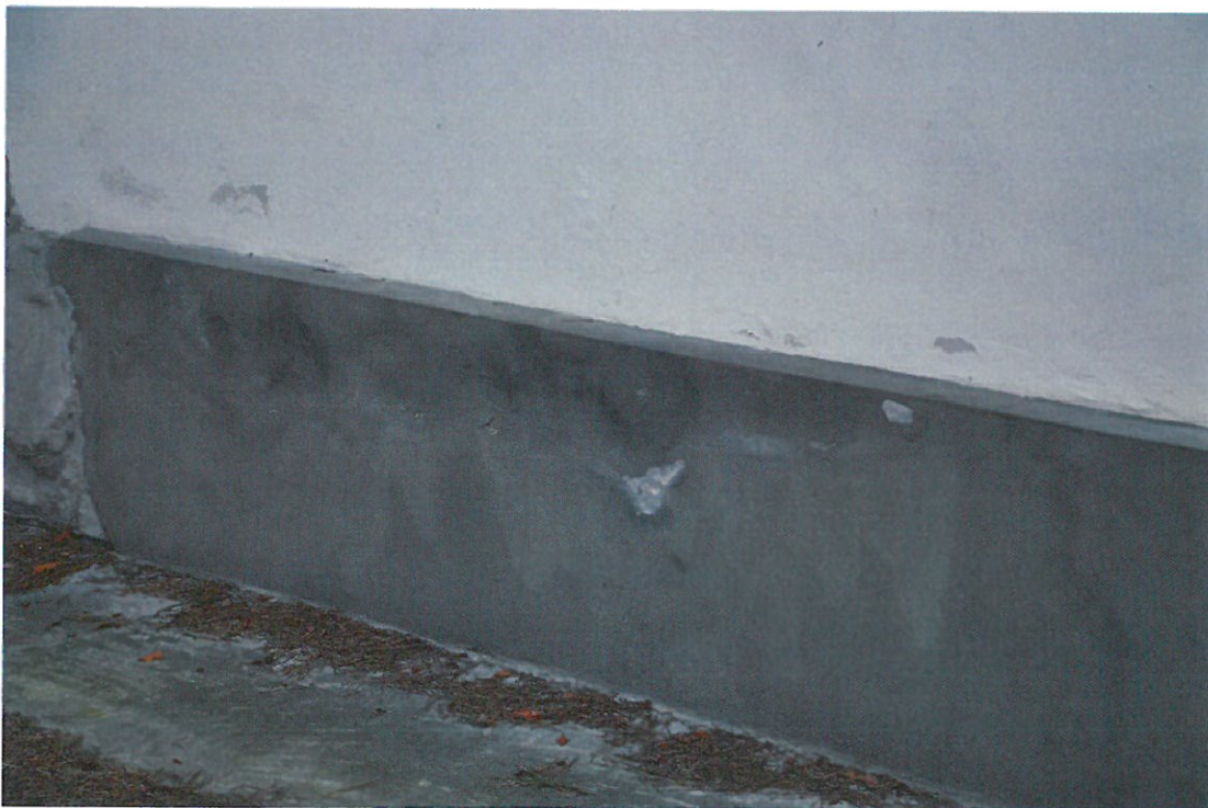
Fot.14. Wysolenia i odparzenia tynku wskazujące na podciąganie kapilarne wody. Jednocześnie widoczny brak otworów wentylacyjnych stropu przyziemia oraz poziome ukształtowanie korony cokołu bez obróbki blacharskiej
