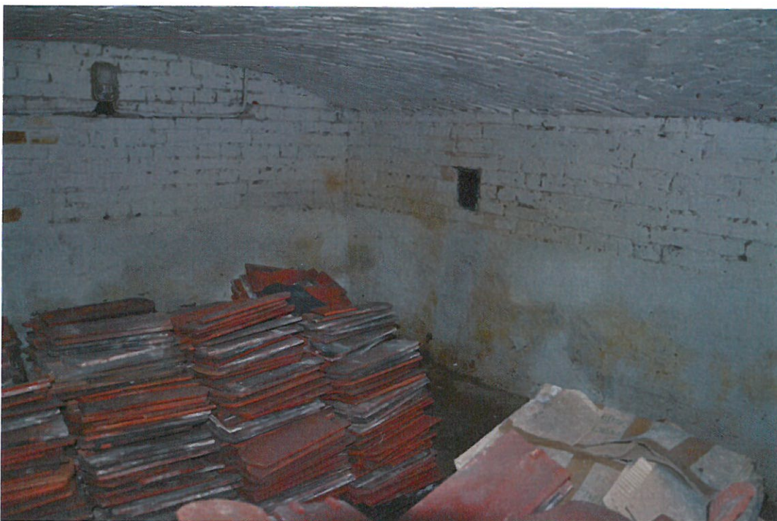
Fot.4. Widok piwnic. Widoczne zawilgocenie ścian (wysolenia, odparzenia) i lokalny wzrost grzybów pleśniowych. Jednocześnie widoczna wtórna wyprawa (tynk cementowy) w miejscach wcześniejszych wysoleń
