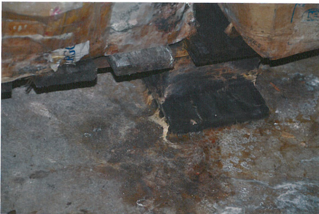
Fot.25. Zagrzybienie (rozkład brunatny) drewnianych przedmiotów znajdujących się w piwnicy. Widoczna grzybnia i sznury grzybniowe grzyba gnilicy mózgowatej
