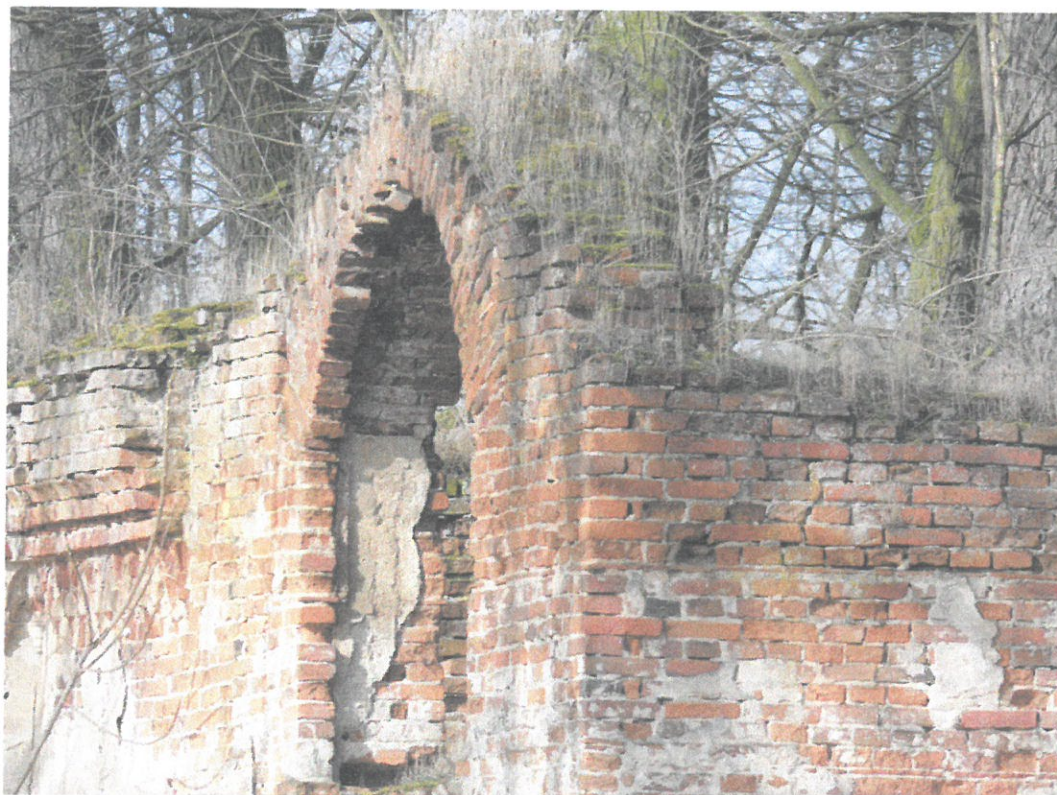
Fot. 2 Widok na intensywnie porastane korony murów oraz łuk który zapewne będzie wymagał wzmocnienia konstrukcyjnego.
