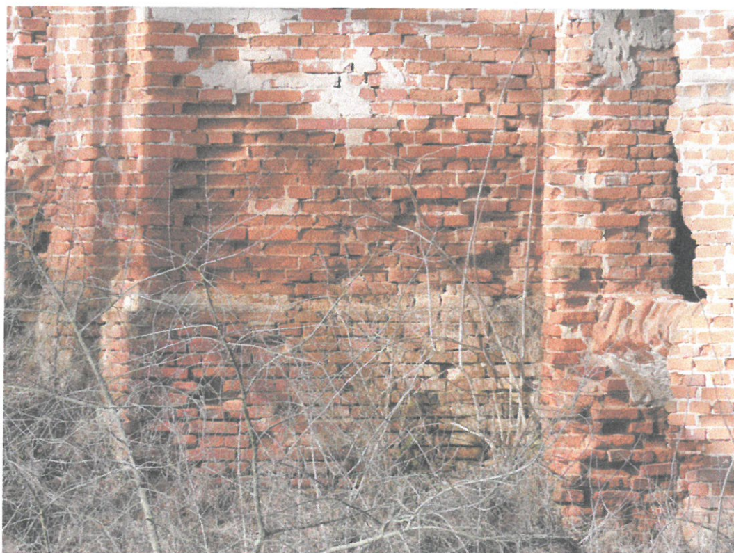
Fot. 4 Zbliżenie na dolne partie elewacji silnie zniszczone przez oddziaływanie wody wraz z solami rozpuszczalnymi w wodzie.
