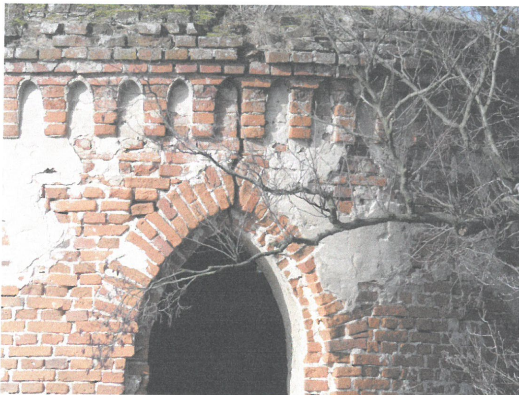
Fot. 3 Zbliżenie na pęknięcie w obrębie wieży, które należy spiąć.
