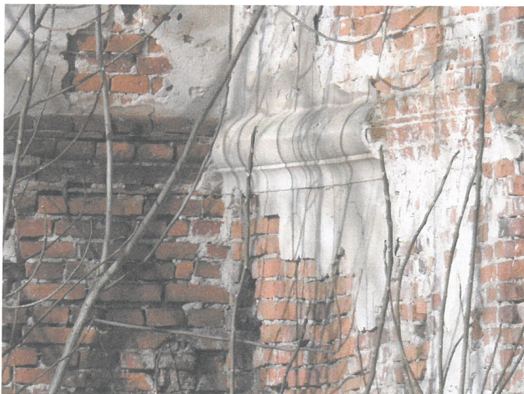
Fot. 6 Zbliżenie na pozostałość profilu gzymsu.
